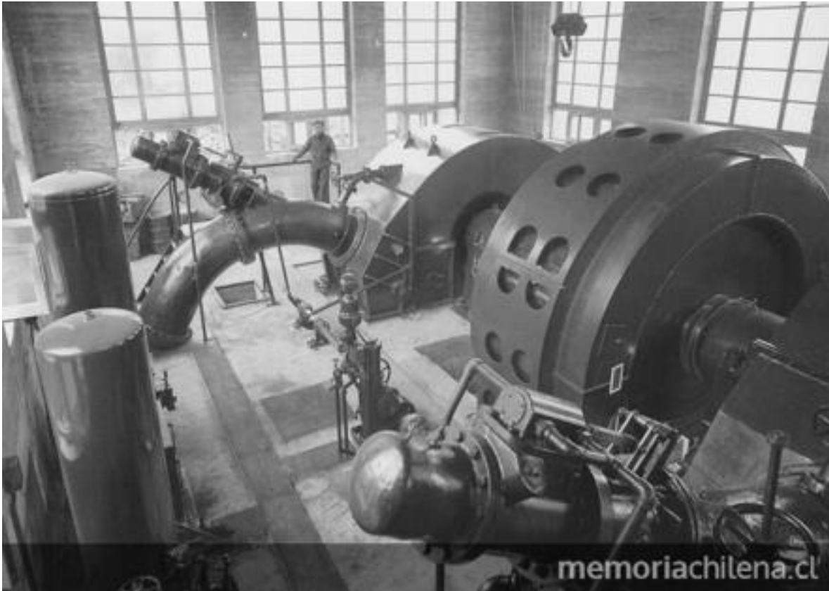
Figura 3.4: Interior de la Central Hidroeléctrica de los Maitenes en el río Colorado, hacia 1921. Fuente: Archivo fotográfico CHILECTRA / ENERSIS, 2001
